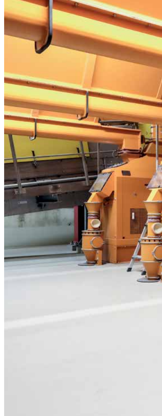
In den Trenntischen werden die Nichteisenmetalle aufgrund ihrer
