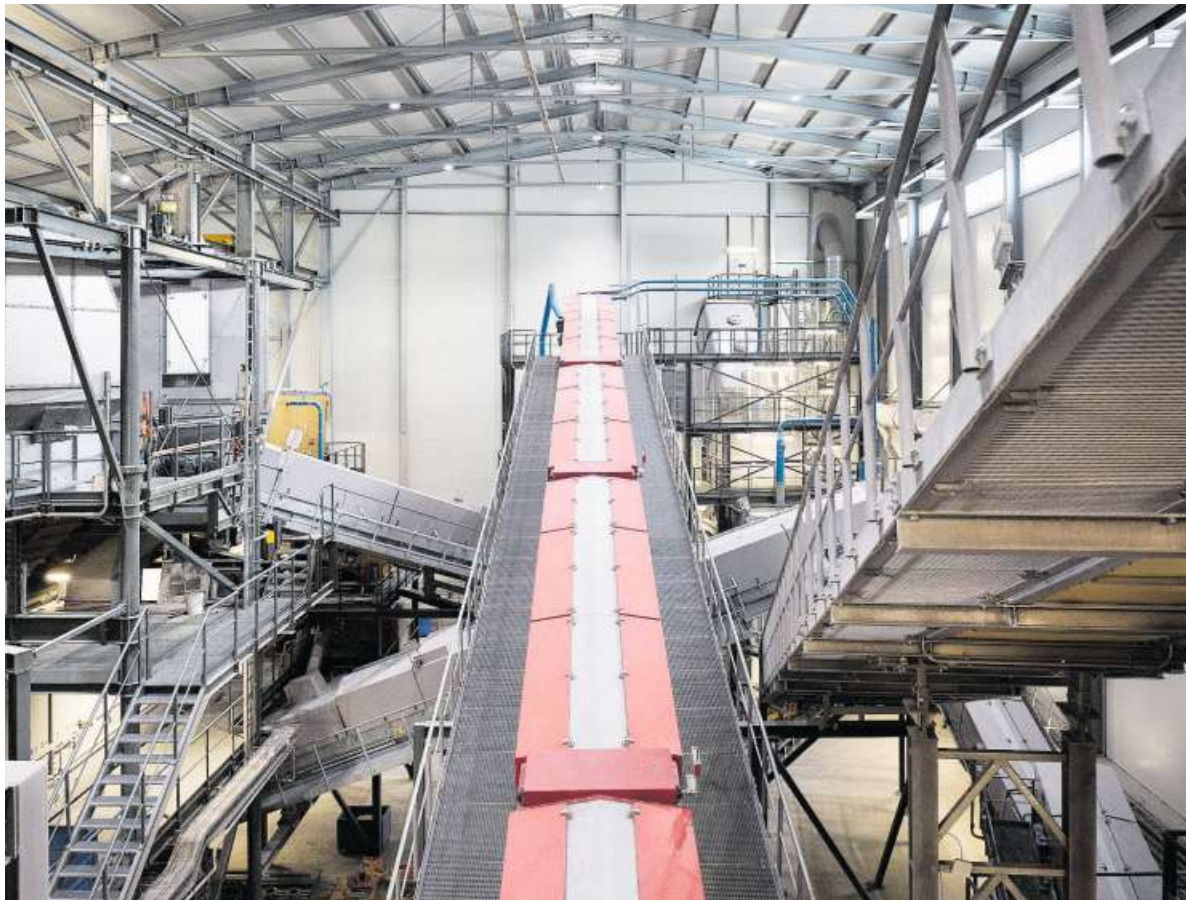
Geschlossene Förderbänder transportieren trockene Kehrichtschlacke – staubfrei.
