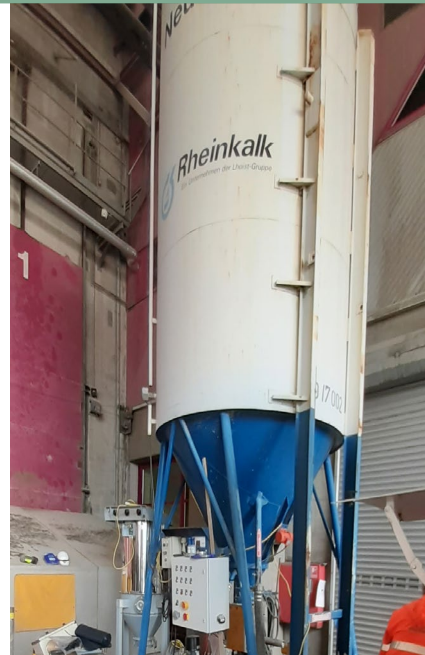
Silo für Kalkeindüsung in den Brennraum.
